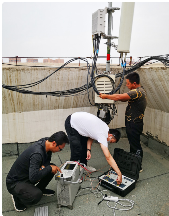
内蒙古无线电管理人员进行基站检测。
