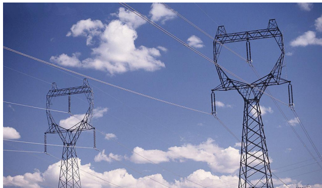
中高压（小于35KV） 高架高压线
