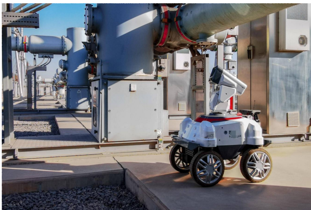
图 3-11 某变电站机器人巡检
