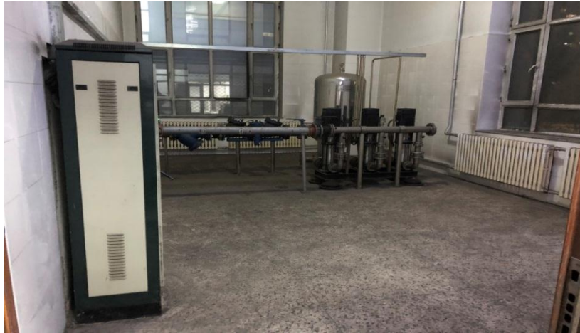
图 14：无负压供水设备
