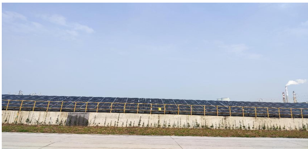
光伏发电系统
