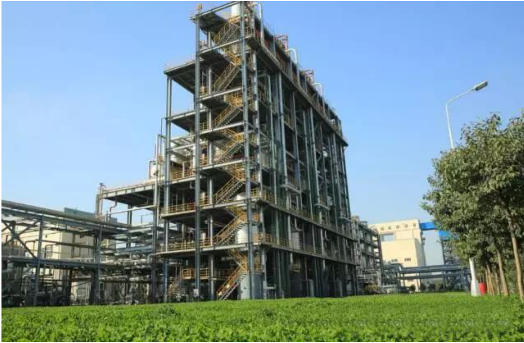
四喷嘴对置式水煤浆气化工序装置
