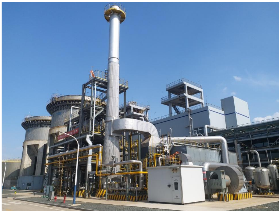
50t/h 氢气锅炉
