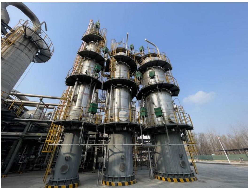
低温甲醇洗中压系统改造
