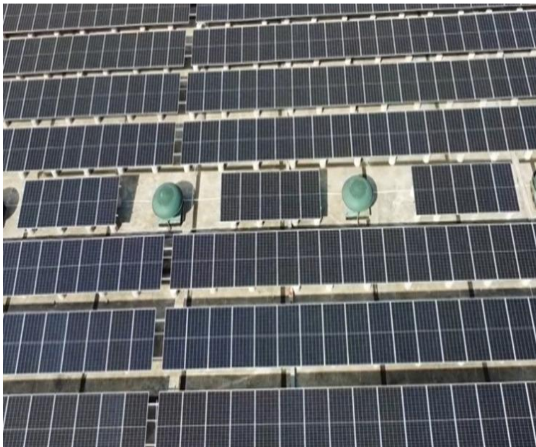
光伏发电系统
